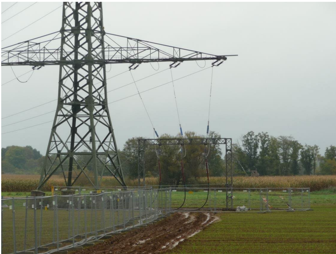
Abbildung 14 Abbildung 24 : 110-kV-Kabelprovisorium mit Übergangportal
